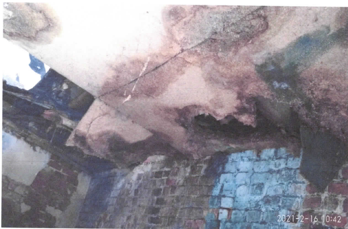
Fot. 4 Uszkodzenia konstrukcji stropu.
