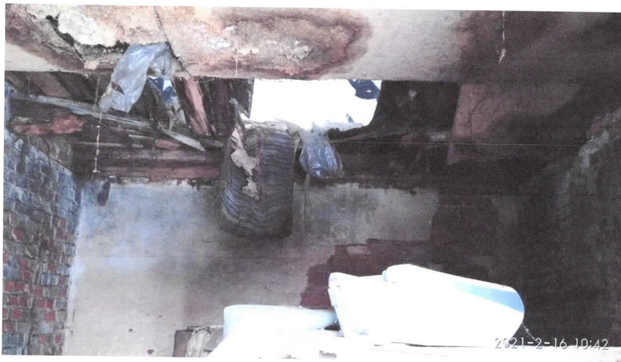
Fot. 3 Uszkodzenia konstrukcji stropu.
